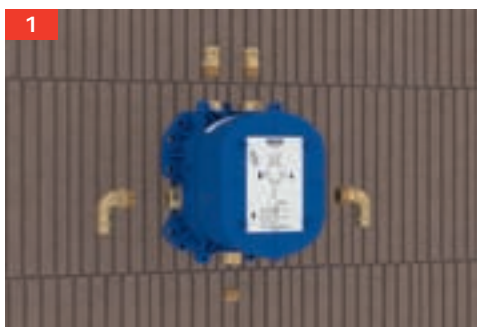
1 Osadte potrubní spojky
